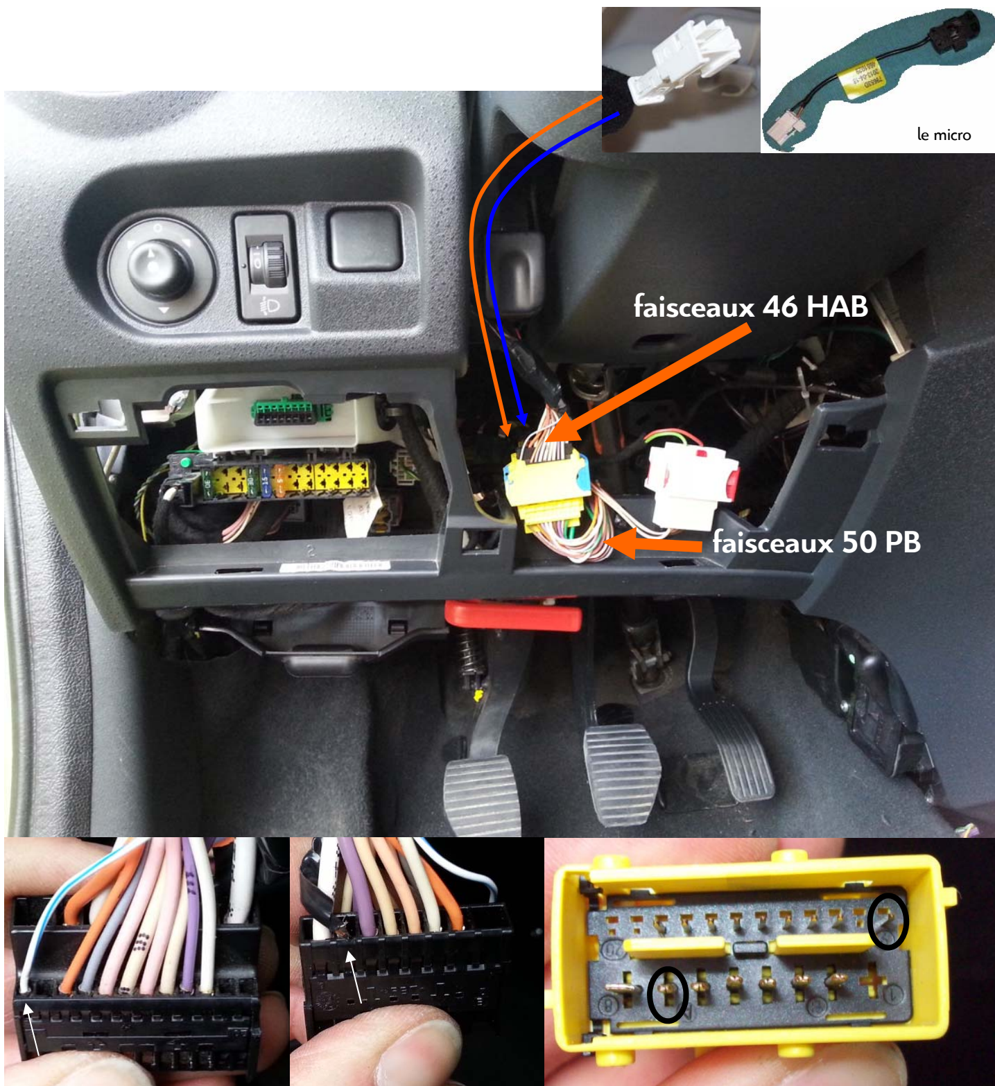
Les 2 fils du Micro arrivent du plafonnier ici sur les bornes 7 et 9
